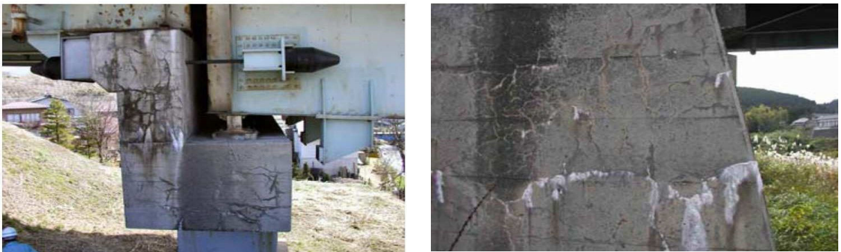
写真 2.5.5 ASR による損傷事例
