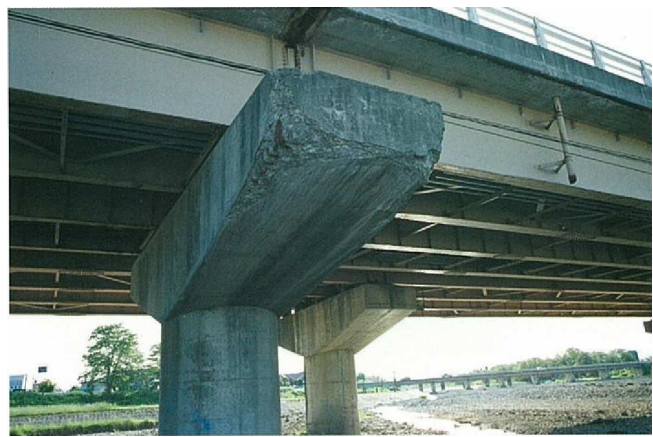
写真 2.5.6 凍害による損傷事例
