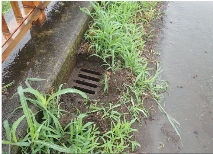
写真 1.4.3 排水工の土砂だまりの例
