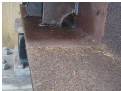
耐候性鋼材ウロコ状腐食
