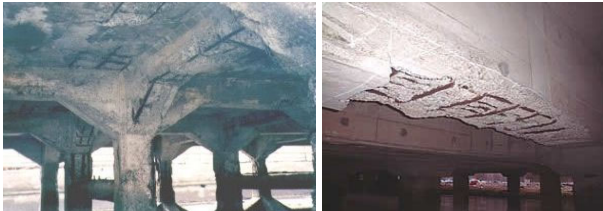
写真 2.5.4 塩害による損傷事例
