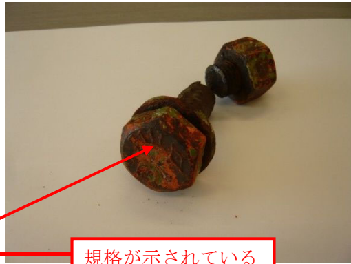
写真 2.4.4 F11T 遅れ破壊破断
