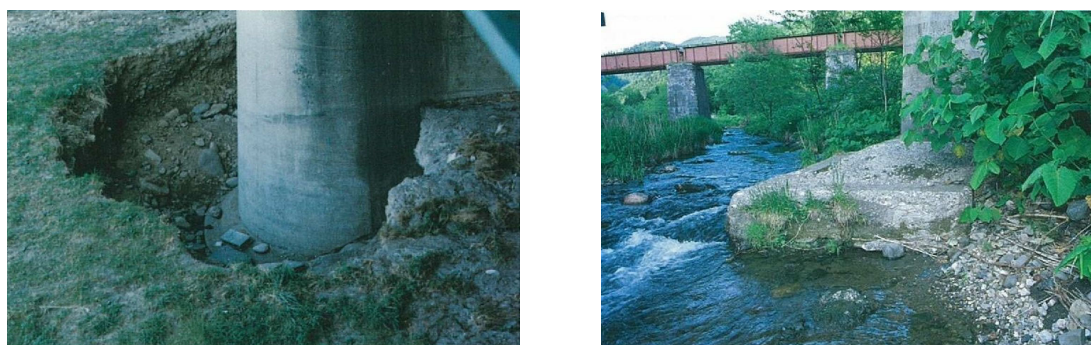
写真 2.5.7 橋脚基礎洗掘の事例
