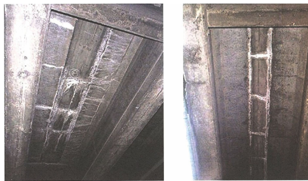
写真 2.5.1 床版間詰部ひび割れ状況
