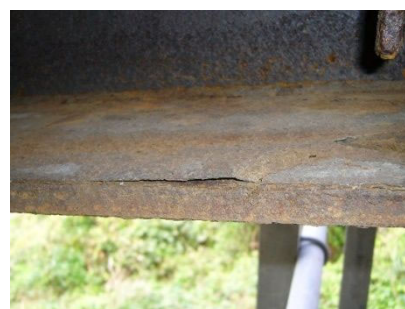
耐候性鋼材層状剥離
