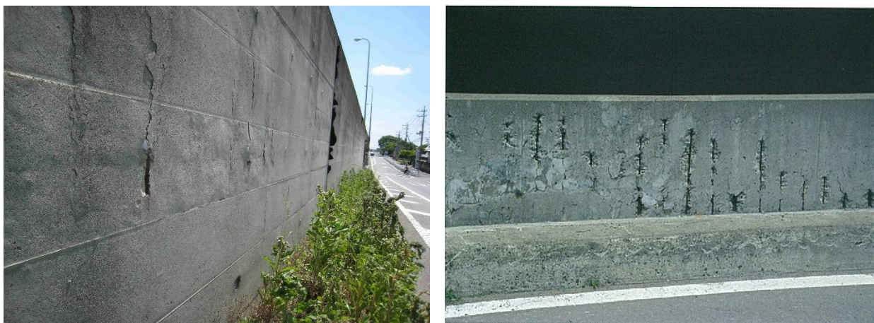
写真 2.5.3 中性化による損傷事例
