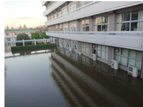
浸水した鬼怒商業高校 普通教室棟
