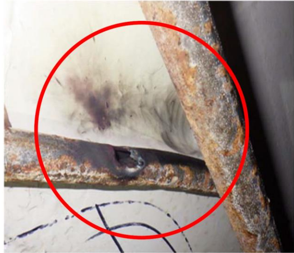
左図拡大図：電線管に穴を確認
