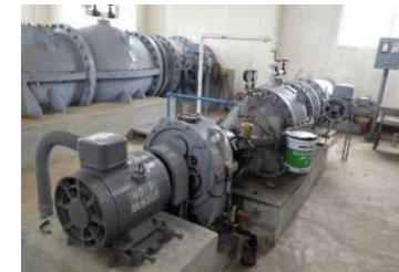
用排水ポンプ設備
