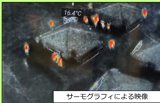
被災モデル建築物の屋根被害
